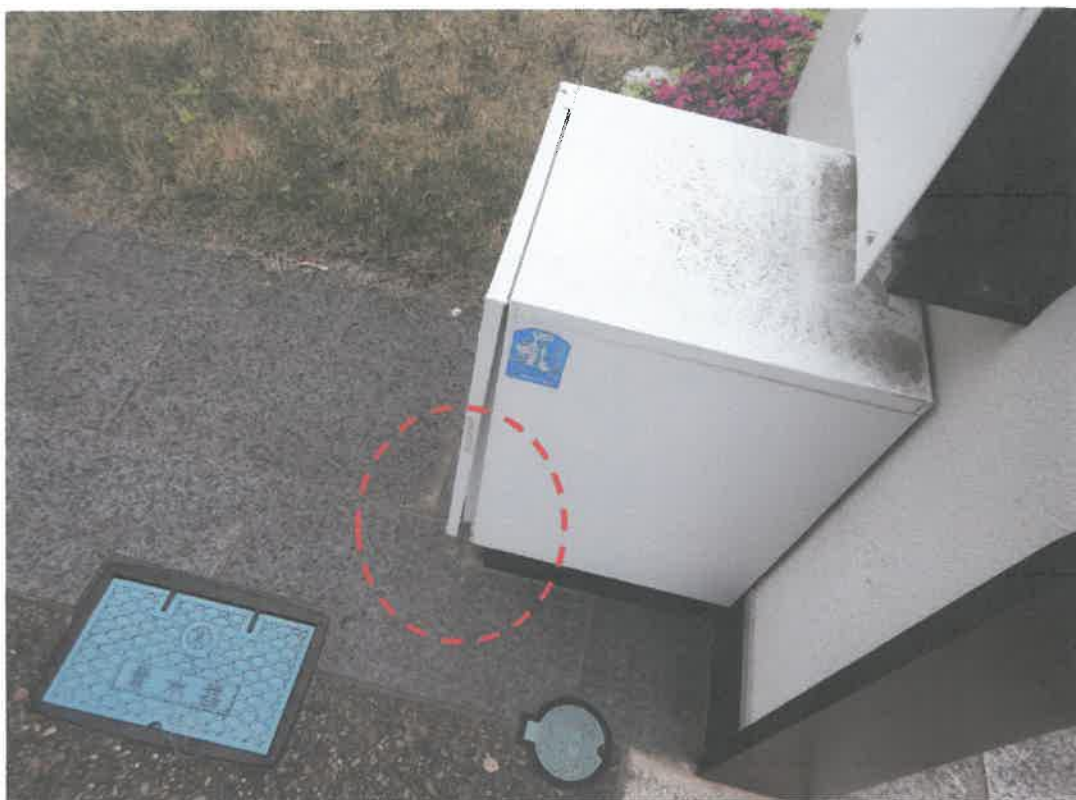
③ 宅配ボックス の損傷
