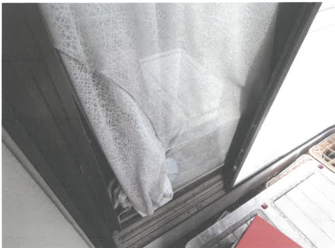
⑤ ガラスの 損傷
