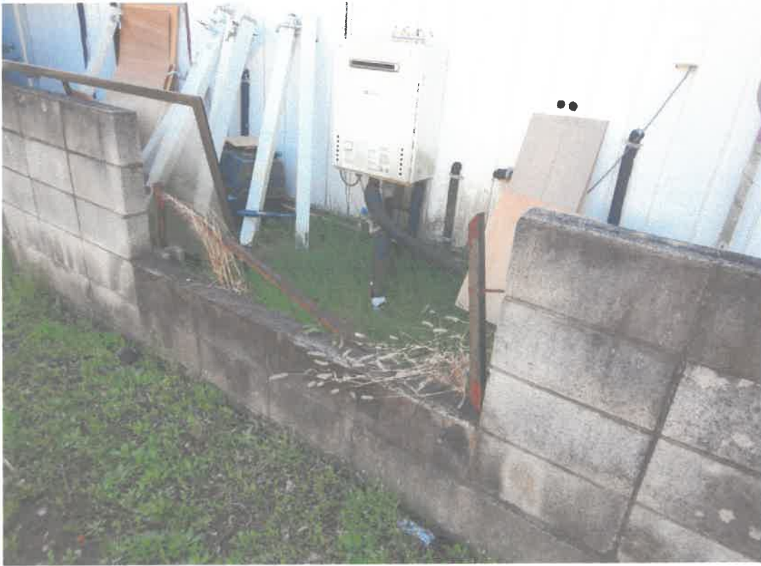
③ フェンスの 損傷
