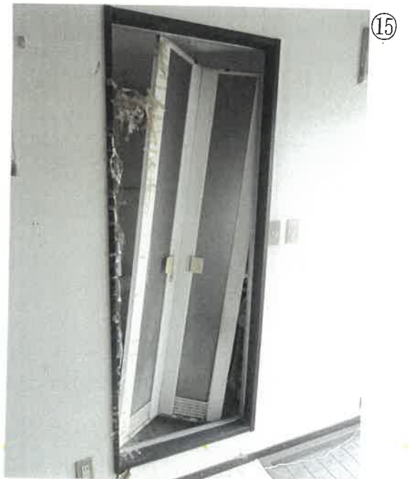
物件17 2階 201号室 浴室の扉が外れている ⑮ 状況
