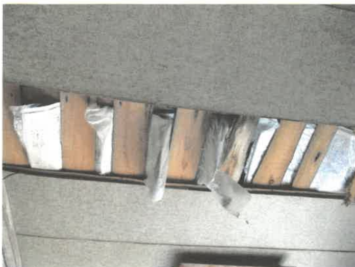
写 真 7 (物件2建物天井損傷箇所)
