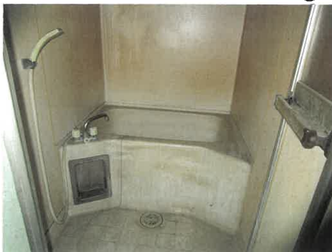
物件15 4階 406号室 浴室の状況 ⑥7
