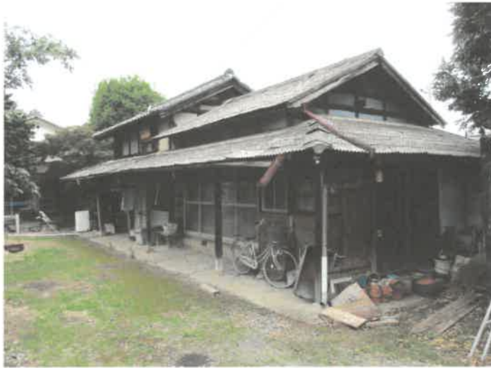
写 真 5 (物件3 建物軒下破損箇所)
