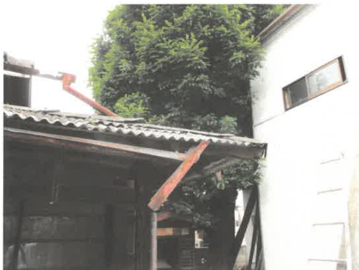
写 真 7 (物件2 附属建物符号2 雨樋破損箇所)
