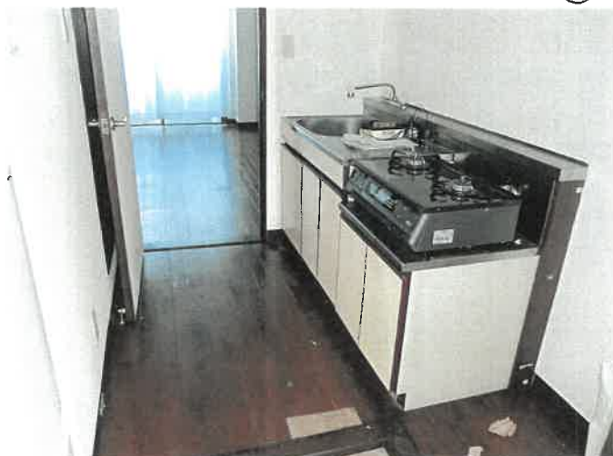
3階 312号室 キッチンの状況 ⑨④
