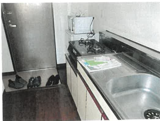
2階 220号室 キッチンの状況 ⑦⑥
