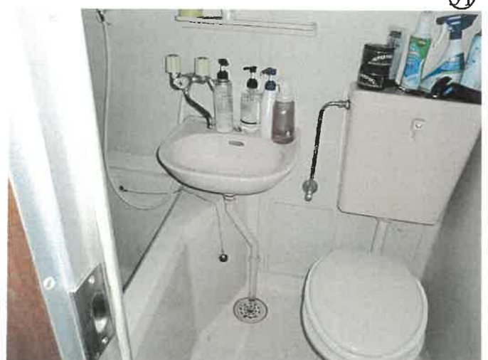
2階 205号室 浴室の状況 (51)
