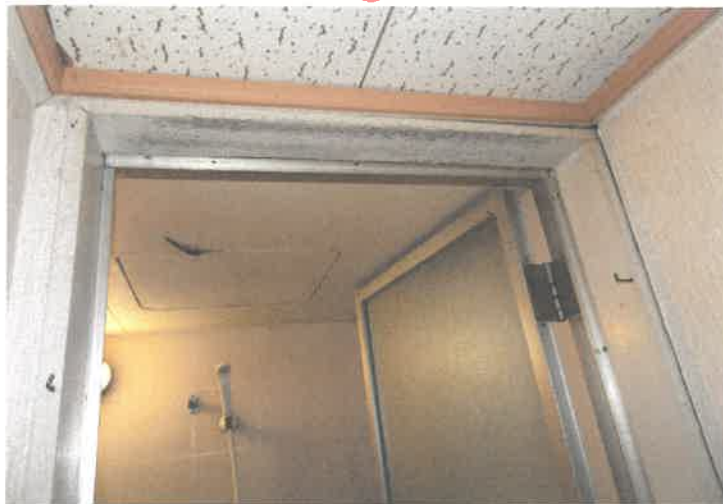
103号室 浴室天井の錆の状況
