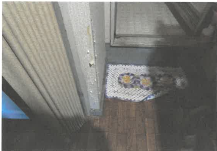
103号室 猫による壁面の爪研ぎ痕の状況
