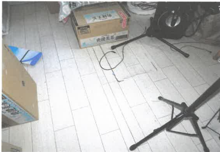
103号室 洋室床の割れの状況
