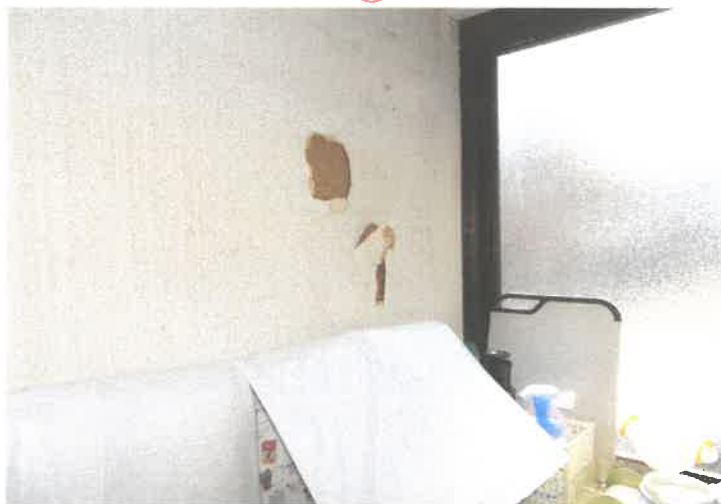
101号室 壁クロスの剥がれの状況
