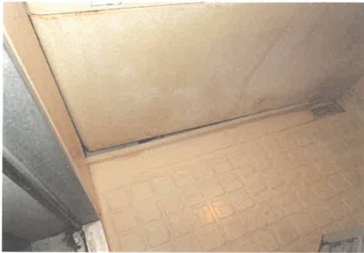
103号室 浴槽のずれの状況
