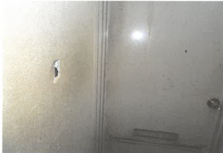
201号室 玄関壁面の穴の状況
