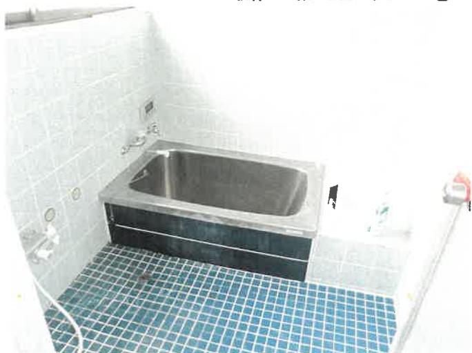
物件6 1階 浴室の状況 ⑯
