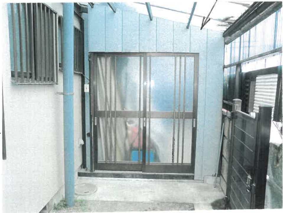
物件3未登記増築部分 物置の状況
