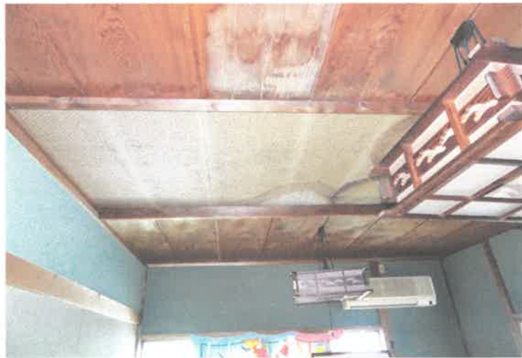
物件3 宴会場(和室)(天井に雨染みがある)
