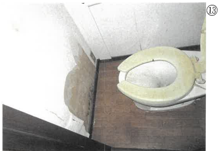
物件5 103号室 トイレ 内壁クロス剥離 の状況
