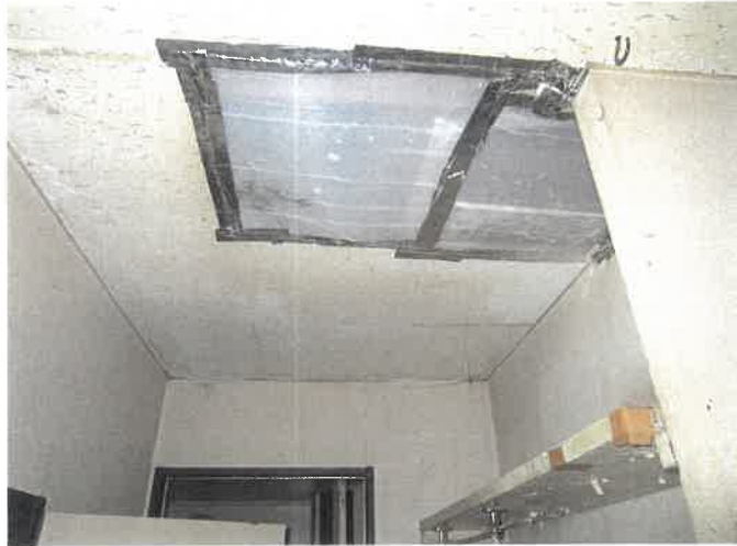
物件5 103号室 天井 損傷の状況 ⑫
