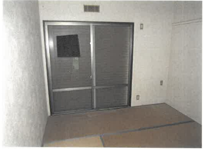
物件5 103号室 和室 の状況 ⑨
