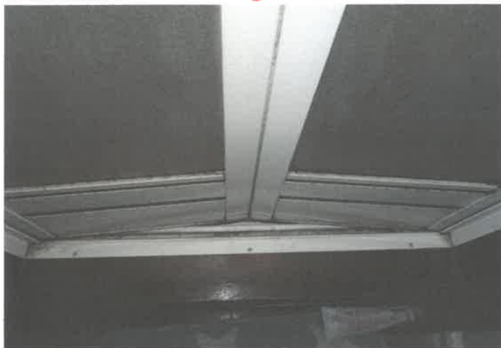
101 浴室出入口扉が閉まらない状況
