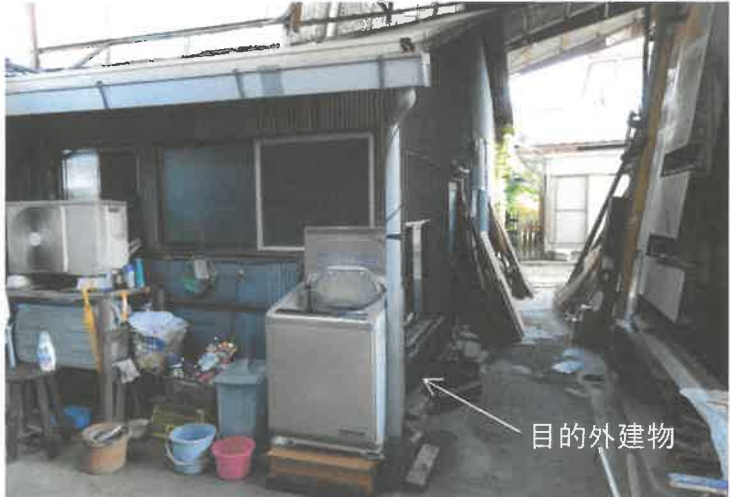
目的外建物の越境付近の状況
