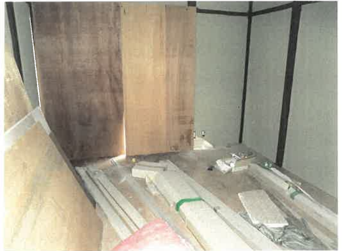
物件2 1階 102号室 和室の状況 ⑫
