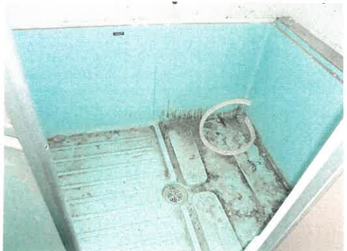
物件2 1階 102号室 浴室の状況 ⑭
