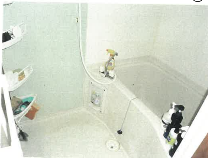
物件4 2階 205号室 浴室の状況 ③3
