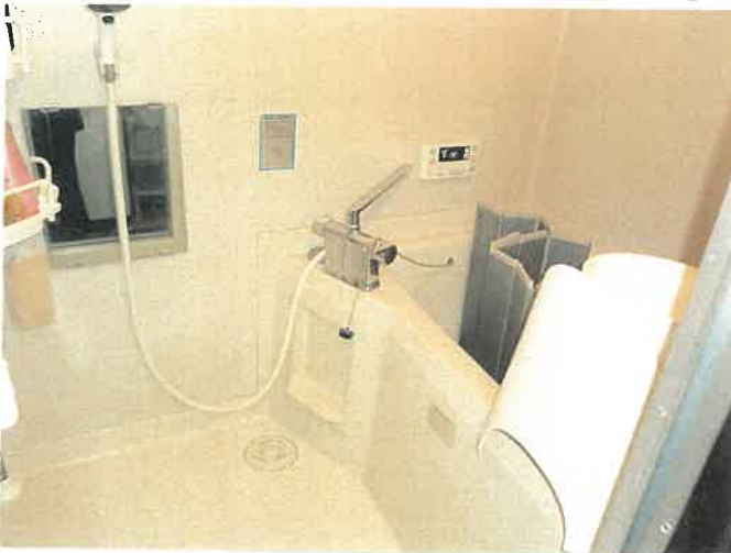
物件7 2階 201号室 浴室の状況 ⑮
