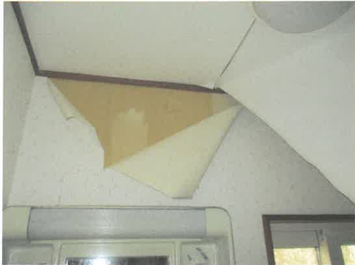
写 真 7（洗面脱衣所の壁紙が剥がれている状況）
