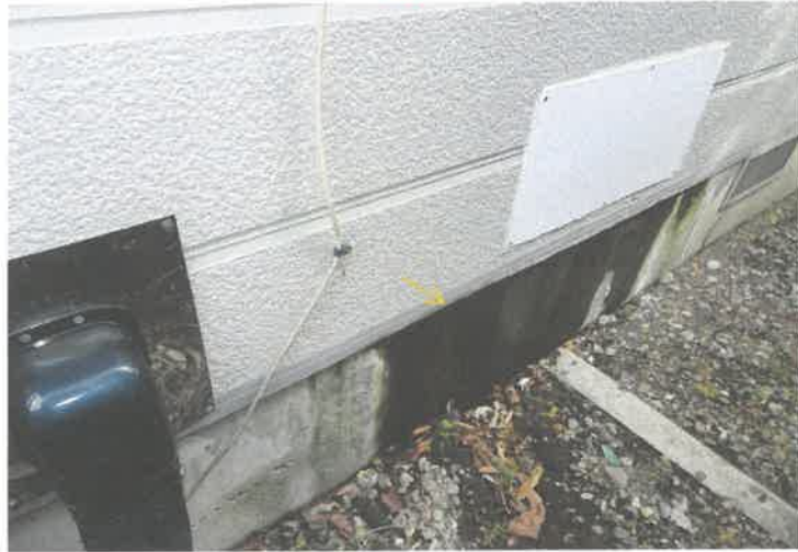
浴室外壁と基礎上部間から水が染み出ている状況
