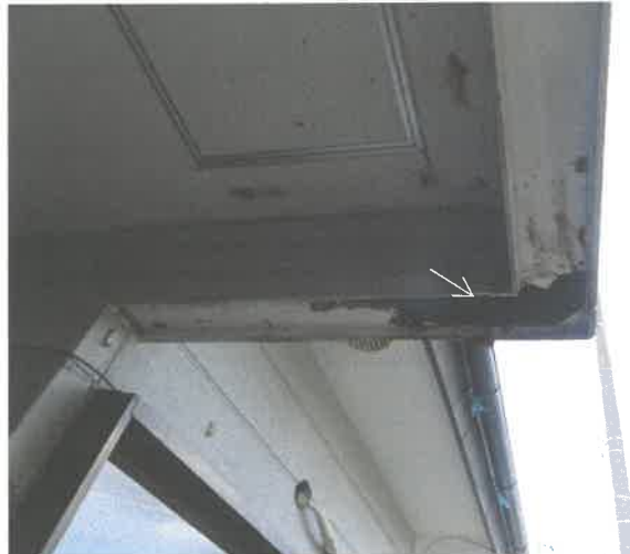
玄関軒天の腐食の状況
