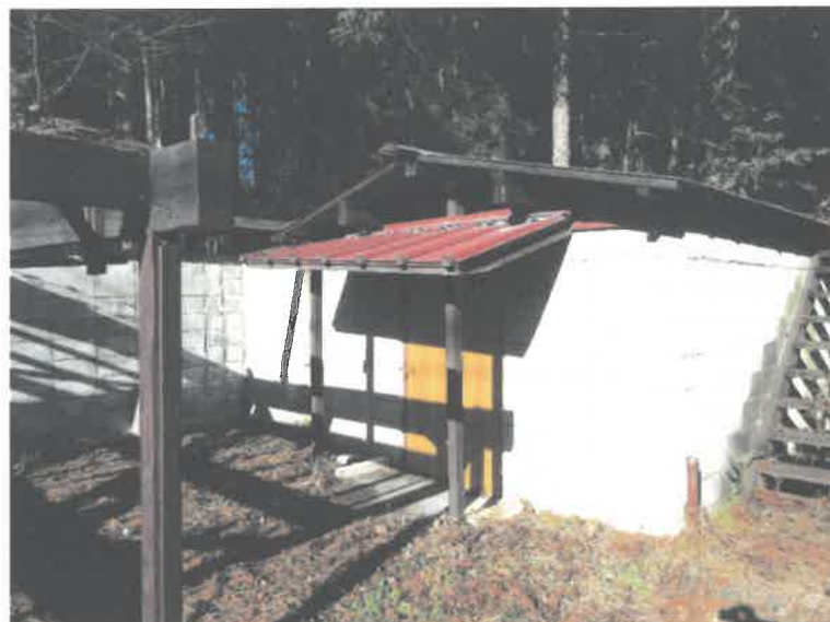
写真2（未登記附属建物）
