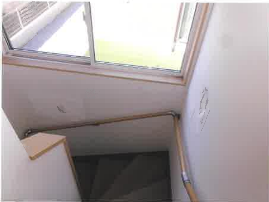
⑩ 壁の破損 (階段部分)
