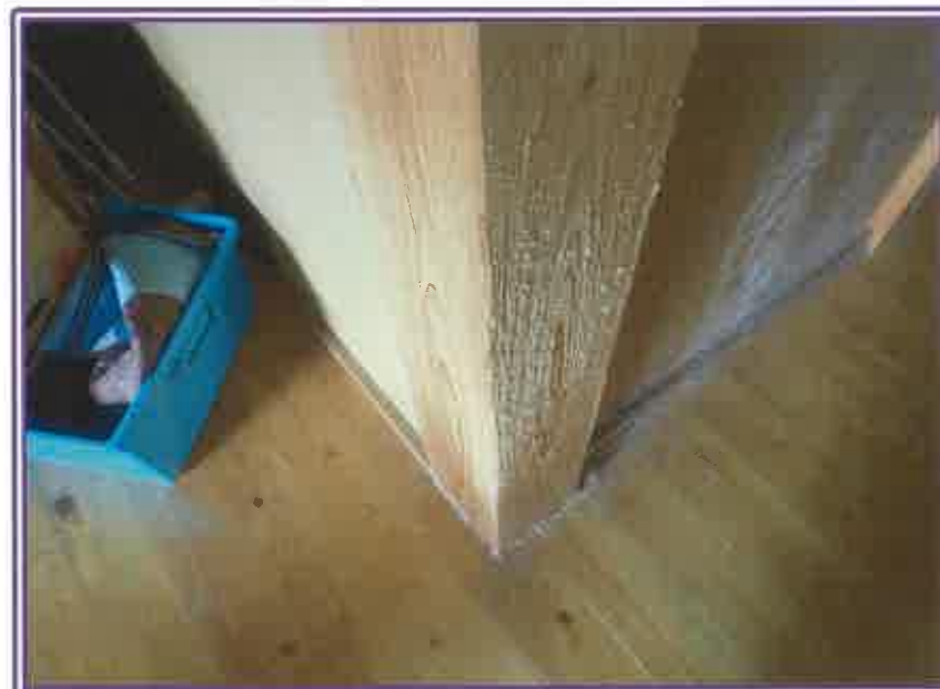
ベットによる柱の損傷箇所
