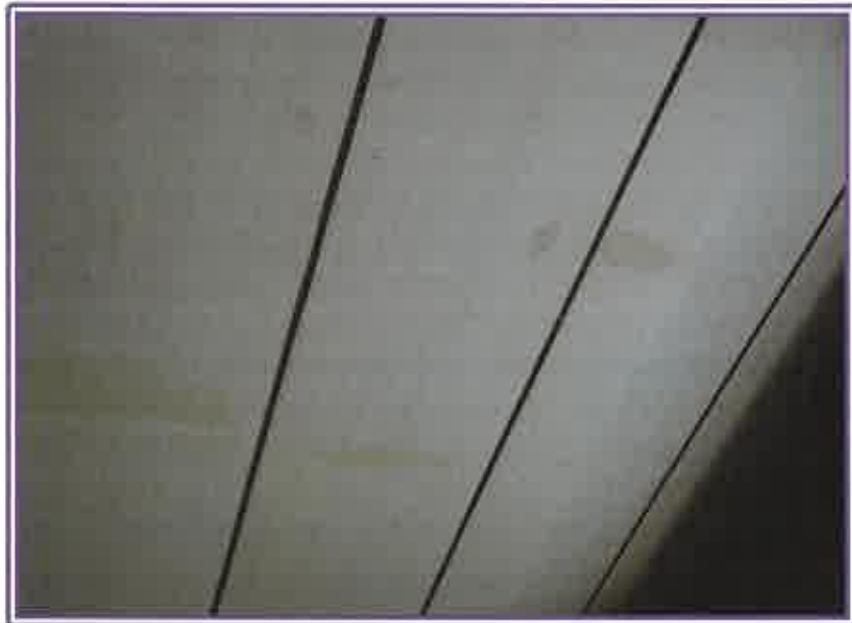
廊下天井に認められるシミ
