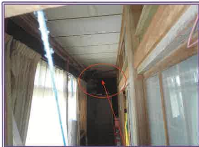
雨漏りによる損傷箇所
