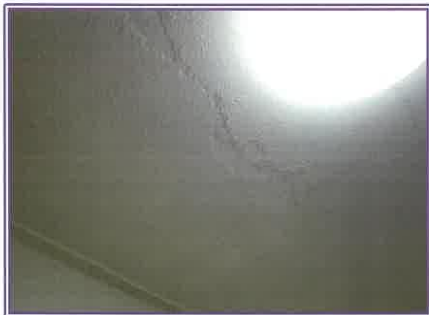
207号室D・K天井の吹きつけが剥離している箇所
