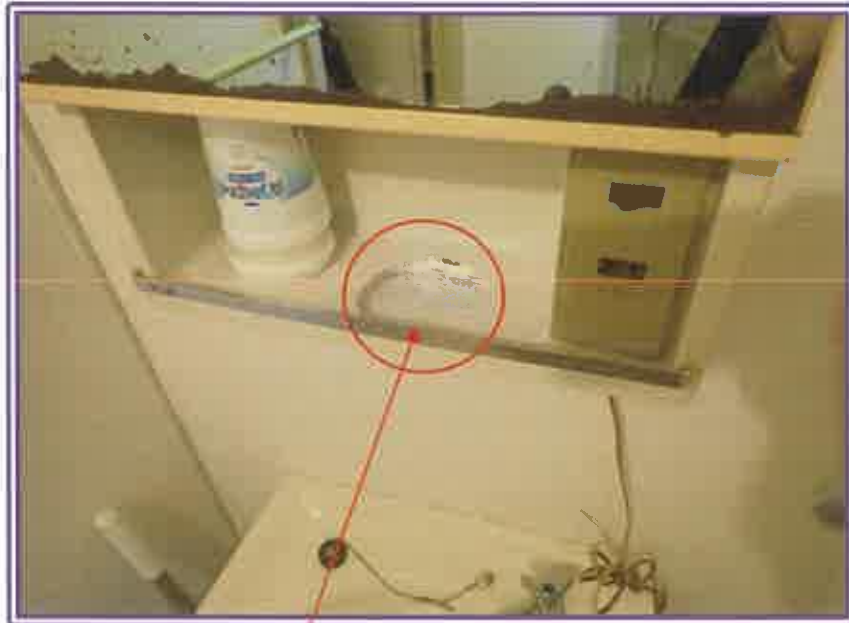
207号室洗面所棚の損傷箇所
