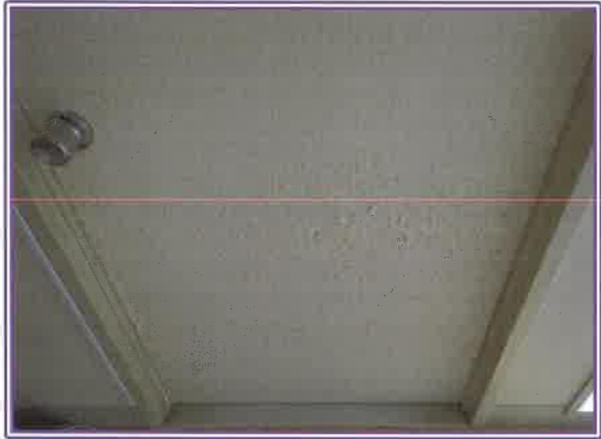
303号室洋室ドアの損傷状況
