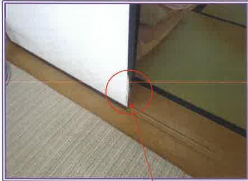
301号室襖の損傷箇所
