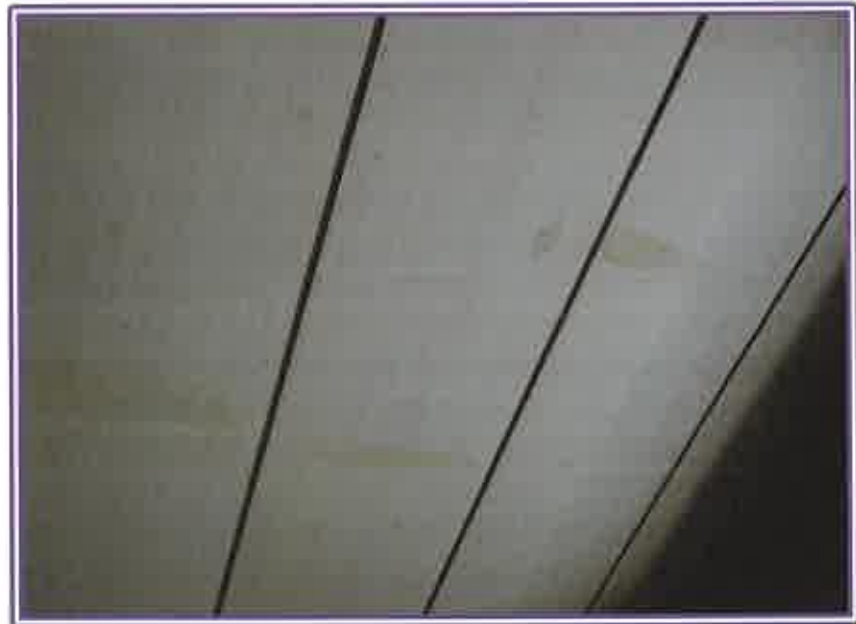
廊下天井に認められるシミ
