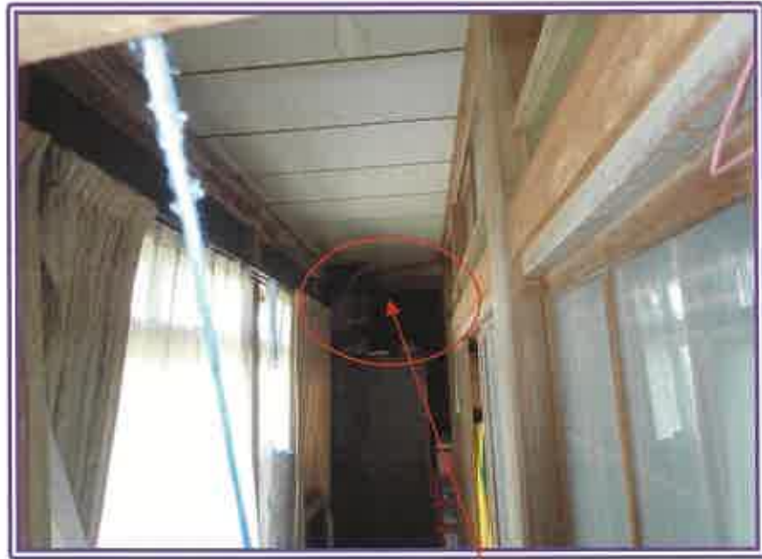
雨漏りによる損傷箇所
