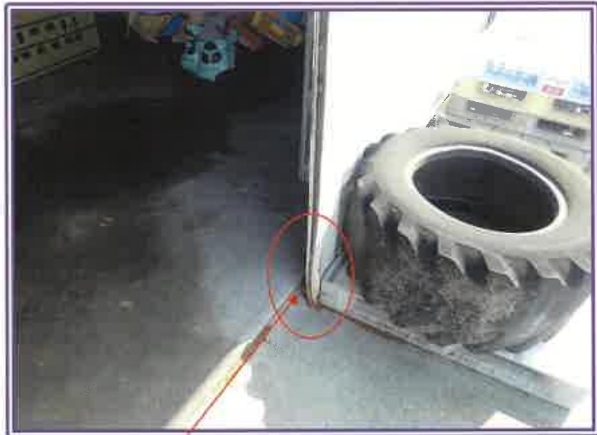
シャッターのレールが湾曲した箇所
