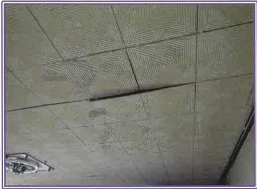
DK天井のパネルが外れかけた箇所
