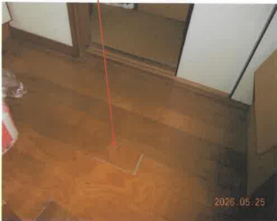
写真 6 本件建物 1 階トイレ前の床板の剥がれ部分（撮影位置の図示は省略）
