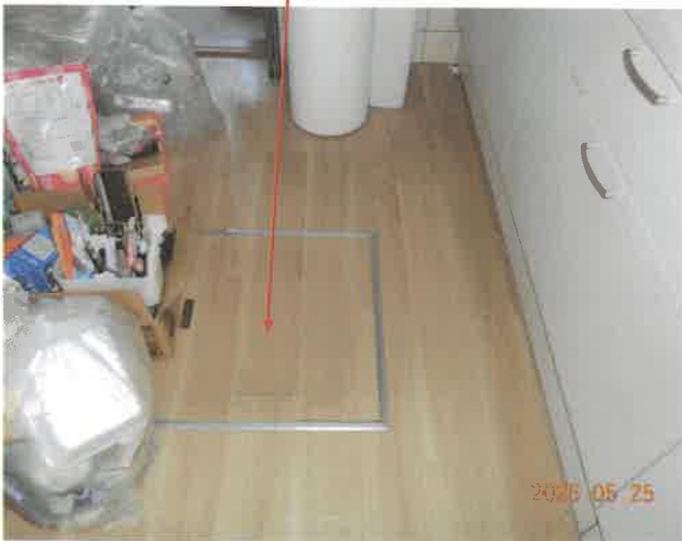
写真 10 本件建物 1 階キッチンの床下収納の床のたわみ部分（撮影位置の図示は省略）
