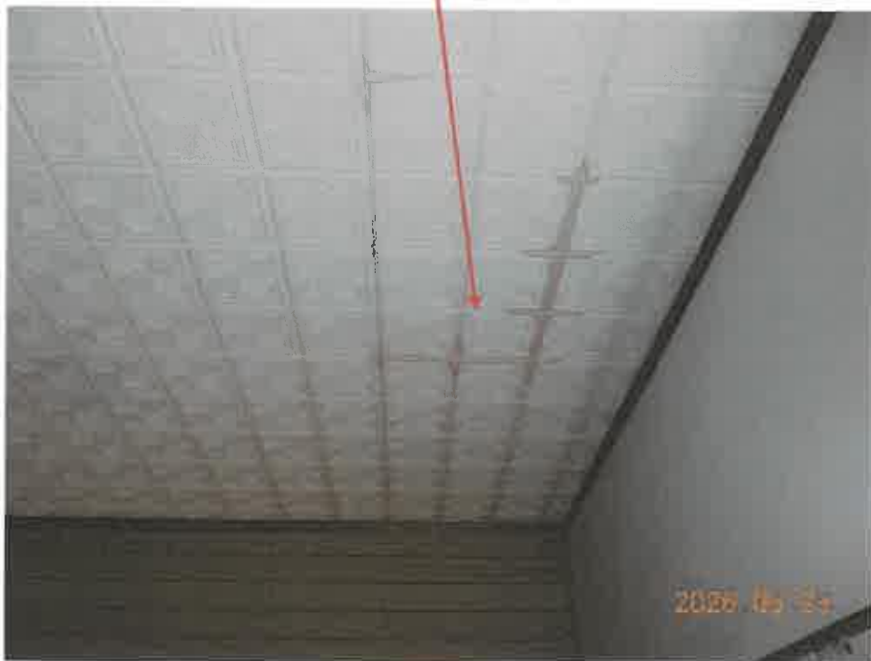
写真 1 5 上記写真 1 3 の本件建物 2 階北東側洋室の天井部分の雨漏り跡（撮影位置の図示は省略）
