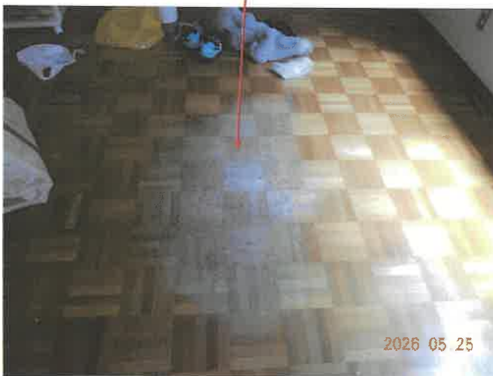
写真 1 4 前記写真 1 3 の本件建物 2 階北東側洋室の床の傷み部分（撮影位置の図示は省略）
