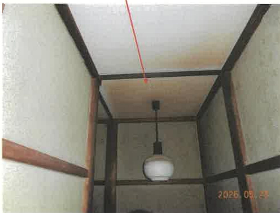
写真 18 本件建物 2 階階段の天井部分の雨漏り跡
