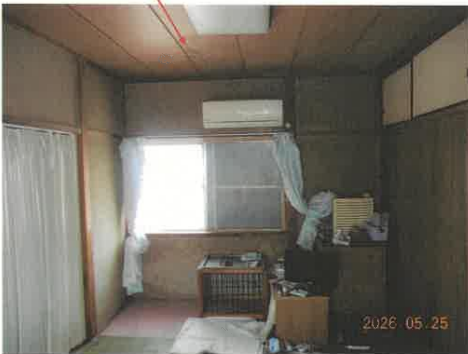
写真 1 6 本件建物 2 階北側和室の天井部分のシミ跡
