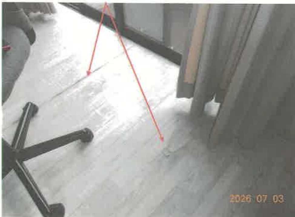
写真 2 0 上記写真 1 9、2 0 の本件建物 2 階 L D K の損傷箇所 (犬の引っ掻き傷跡・撮影位置の図示は省略)
