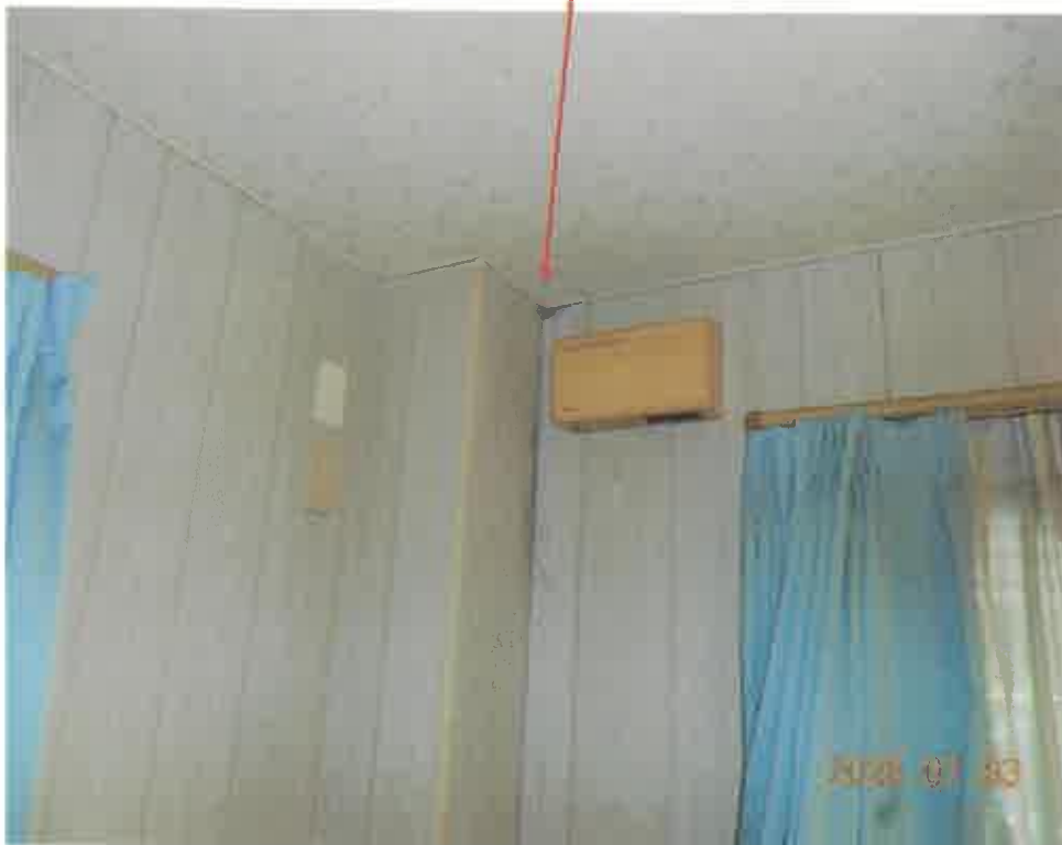
写真 10 前記写真 9 の本件建物 1 階洋室の天井及び内壁部分の雨漏り跡 (撮影位置の図示は省略)
