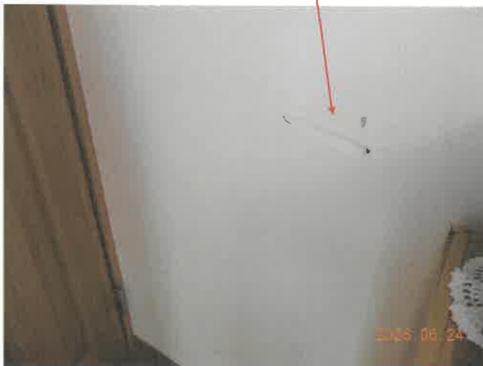
写真 1 2 本件建物 2 階北西側洋室の内壁の損傷（凹み）箇所（撮影位置の図示は省略）
