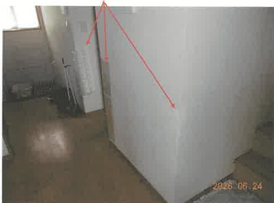
写真9 本件建物1階階段付近の内壁クロスの猫の引っ掻き傷箇所 (撮影位置の図示は省略)
