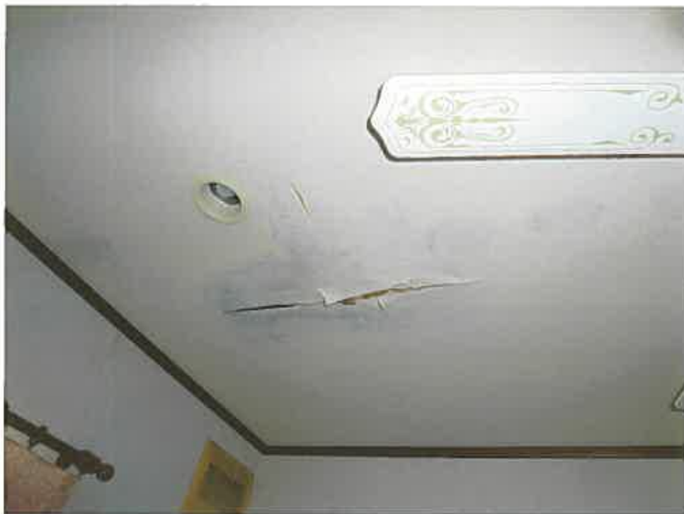
写真5 1階洋室の雨漏り箇所
