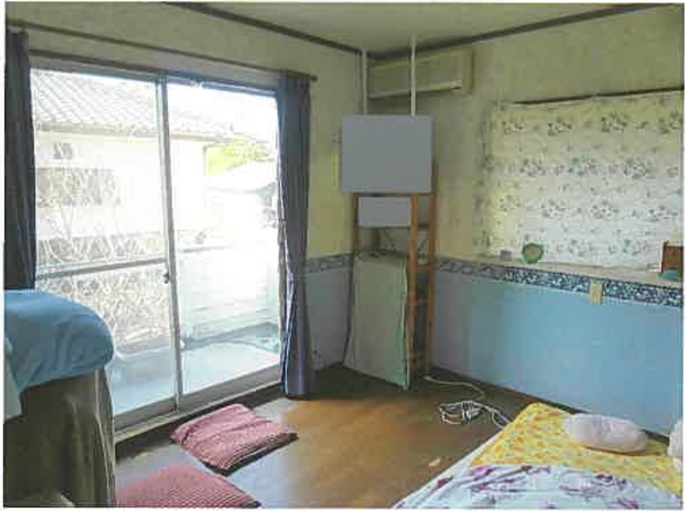
写真10 2階南西側洋室の雨染み跡
