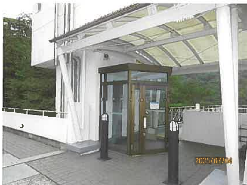
写真7 本件マンション出入口（7階部分）
