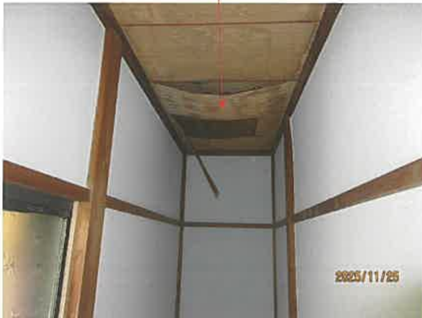
写真 2 0 階段天井の雨漏り
