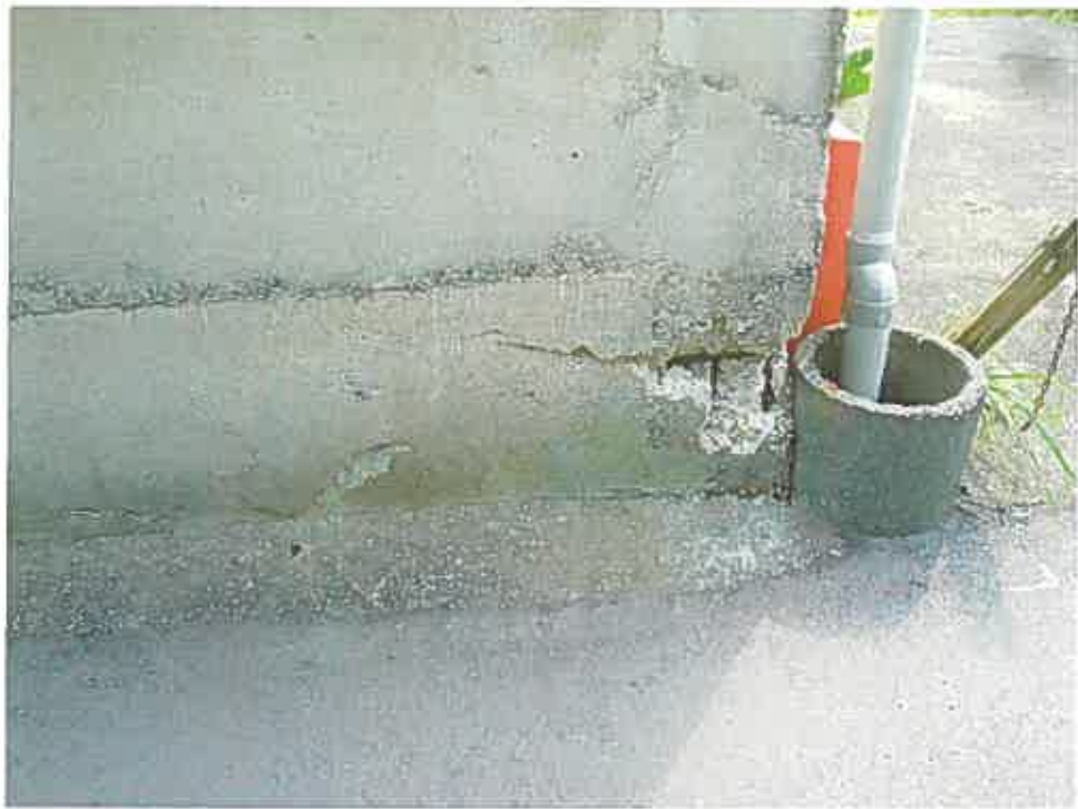
写真5 物件4建物の外壁で鉄骨がむき出しになっている箇所
