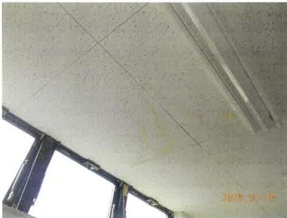
写真１７ 写真１６の建物２階事務室内の天井部分の雨漏り跡（撮影位置の図示は省略）
