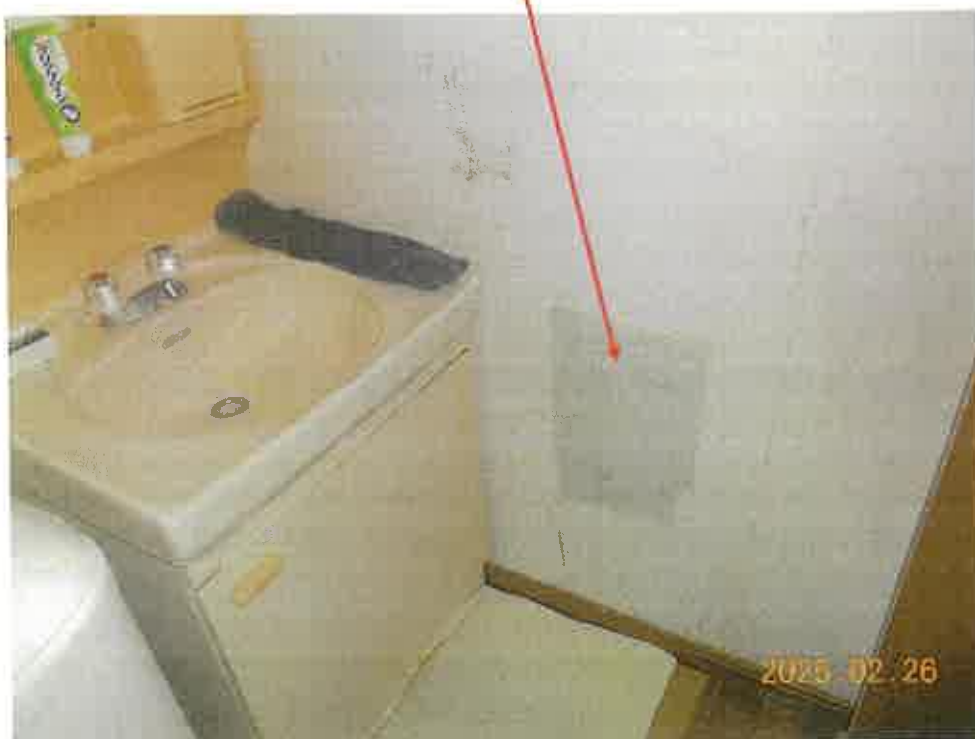
写真 1 2 本件建物 1 階洗面脱衣所の壁穴箇所（撮影位置の図示は省略）
