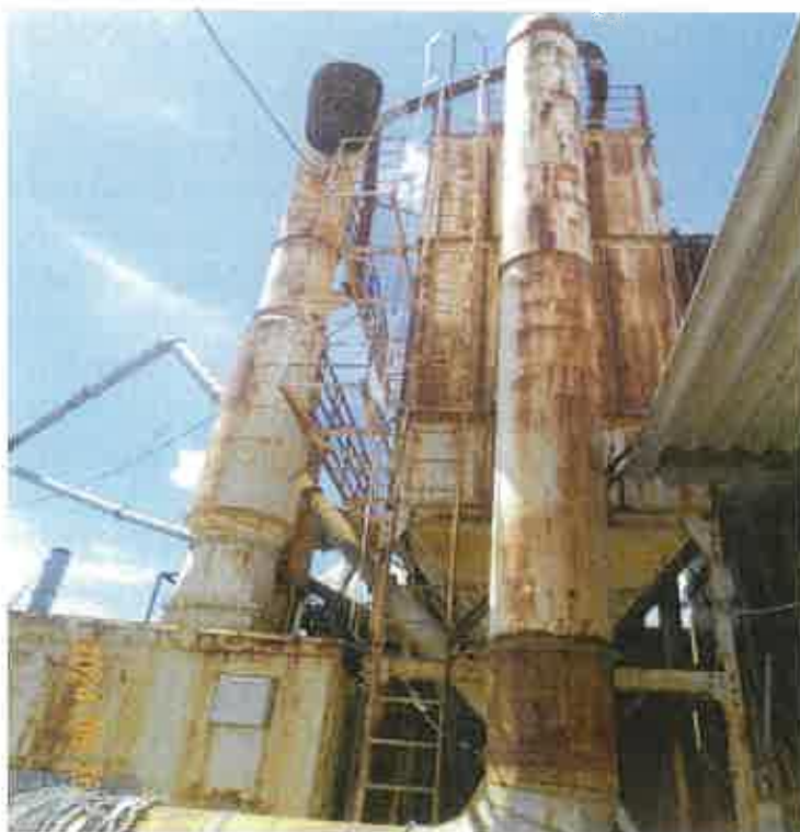
写真 10 集塵機（構築物）
