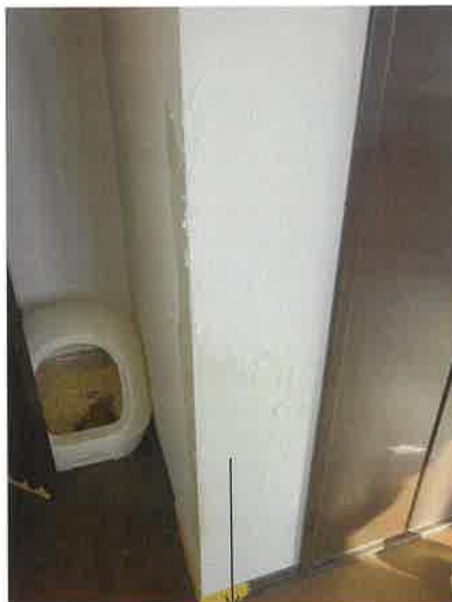
クロスの破損
