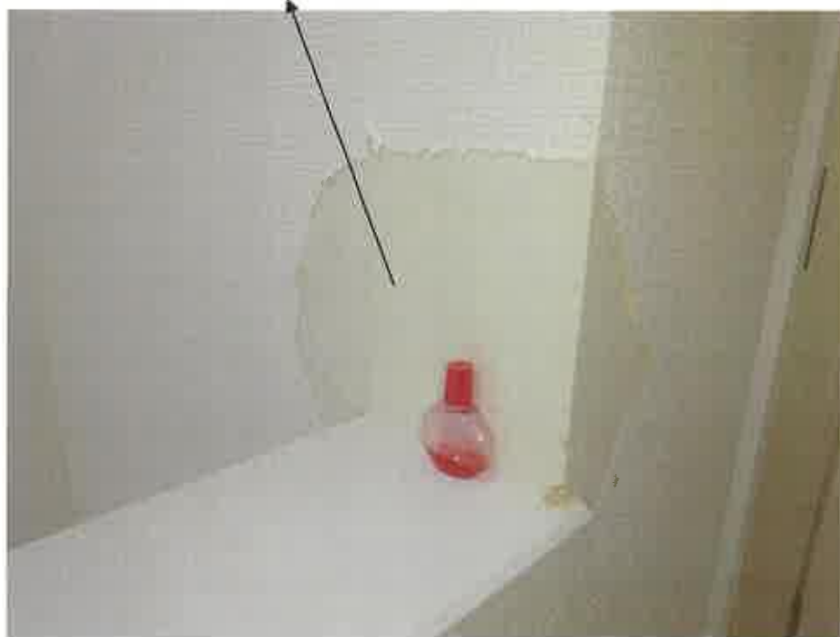
(9) 2階廊下内壁クロス破損
