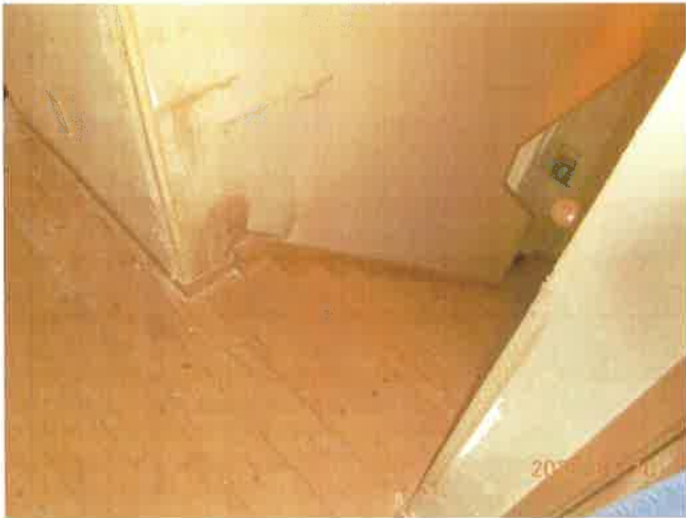
写真 2 1 本件建物 2 階階段付近の壁クロスの損傷箇所
