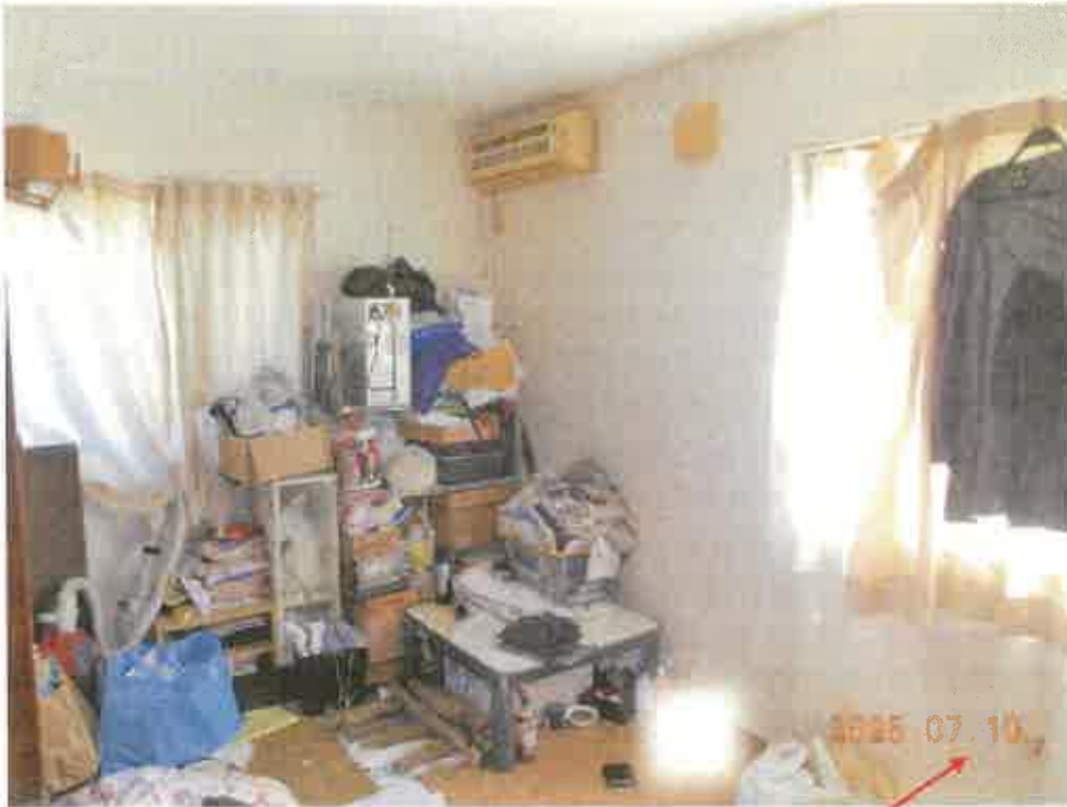
本件建物 1 階南西側洋室の壁クロスの損傷箇所
