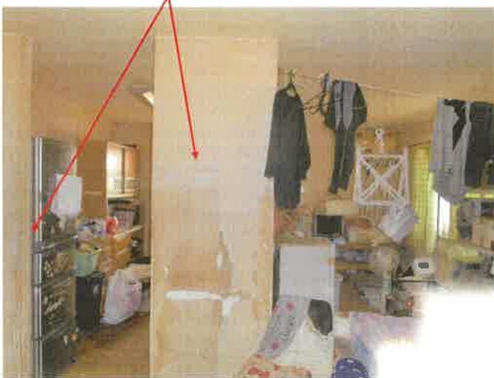
写真13 本件建物1階リビングダイニングキッチンの壁クロスの損傷箇所
