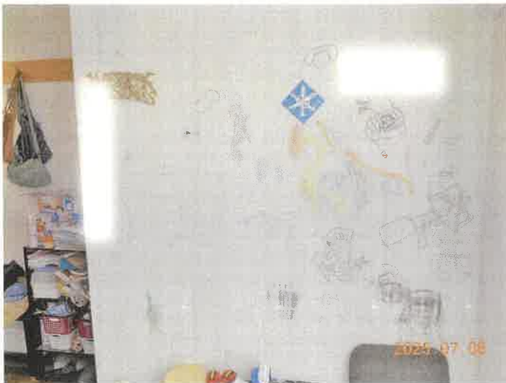
写真25 本件建物2階リビング ダイニング キッチンの壁クロスの落書き跡
