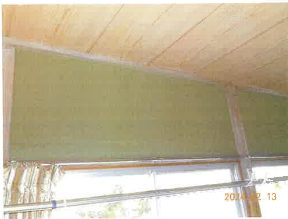
写真17 物件3の建物1階西側和室の天井及び内壁部分の雨漏り跡
