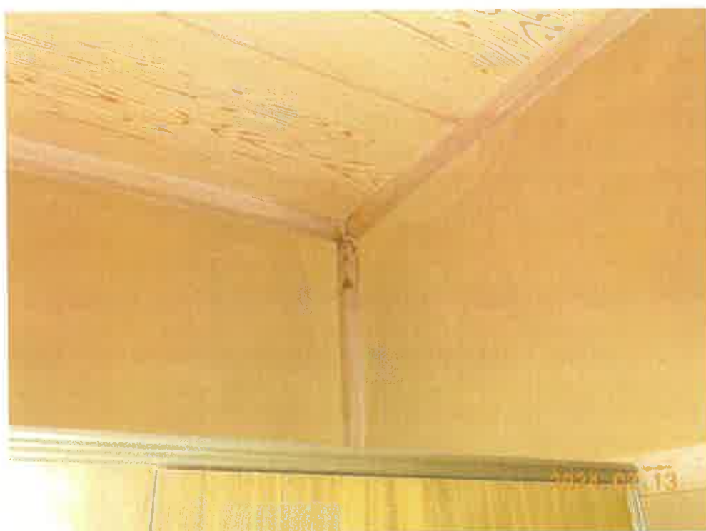
写真20 物件3の建物2階西側和室の天井及び内壁部分の雨漏り跡
