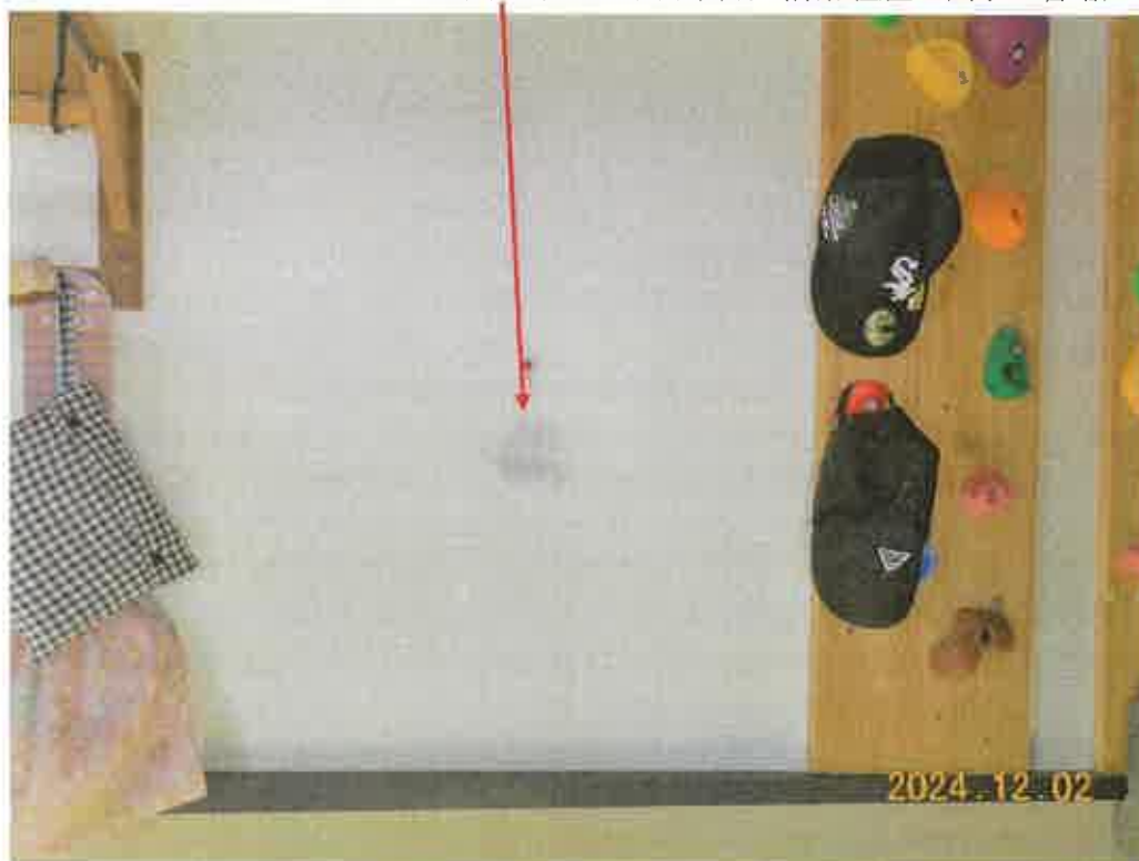
写真 3 4 本件建物 2 階玄関前廊下の内壁の凹み箇所（撮影位置の図示は省略）
