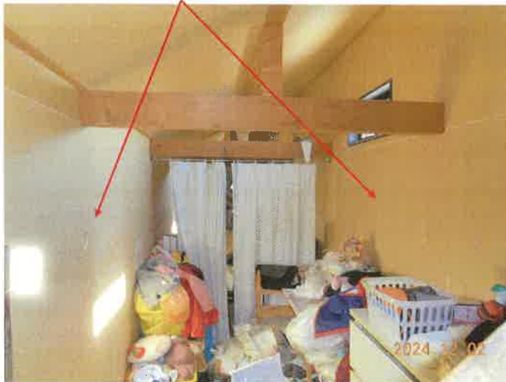
写真 3 1 屋根裏スペースの内壁の凹み箇所
