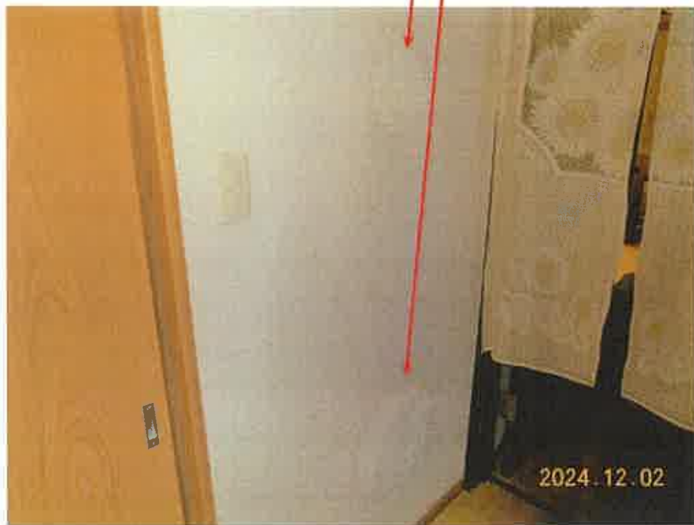
写真 1 7 本件建物 1 階廊下の内壁部分の凹み箇所（撮影位置の図示は省略）
