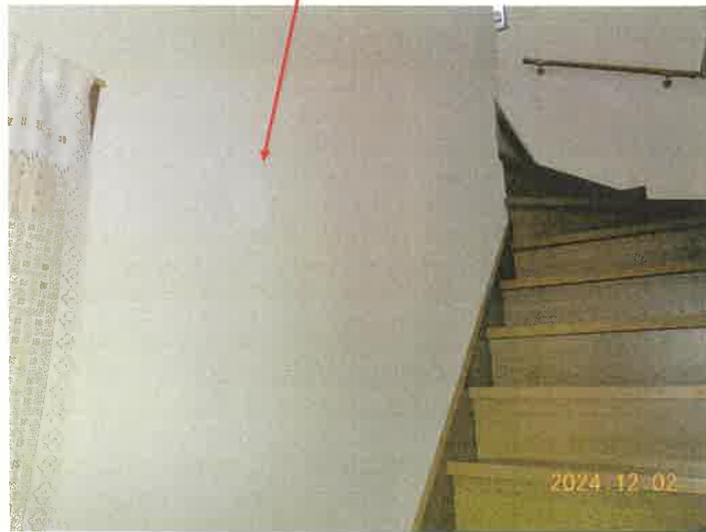
写真 1 8 本件建物 1 階階段付近の内壁部分の凹み箇所（撮影位置の図示は省略）
