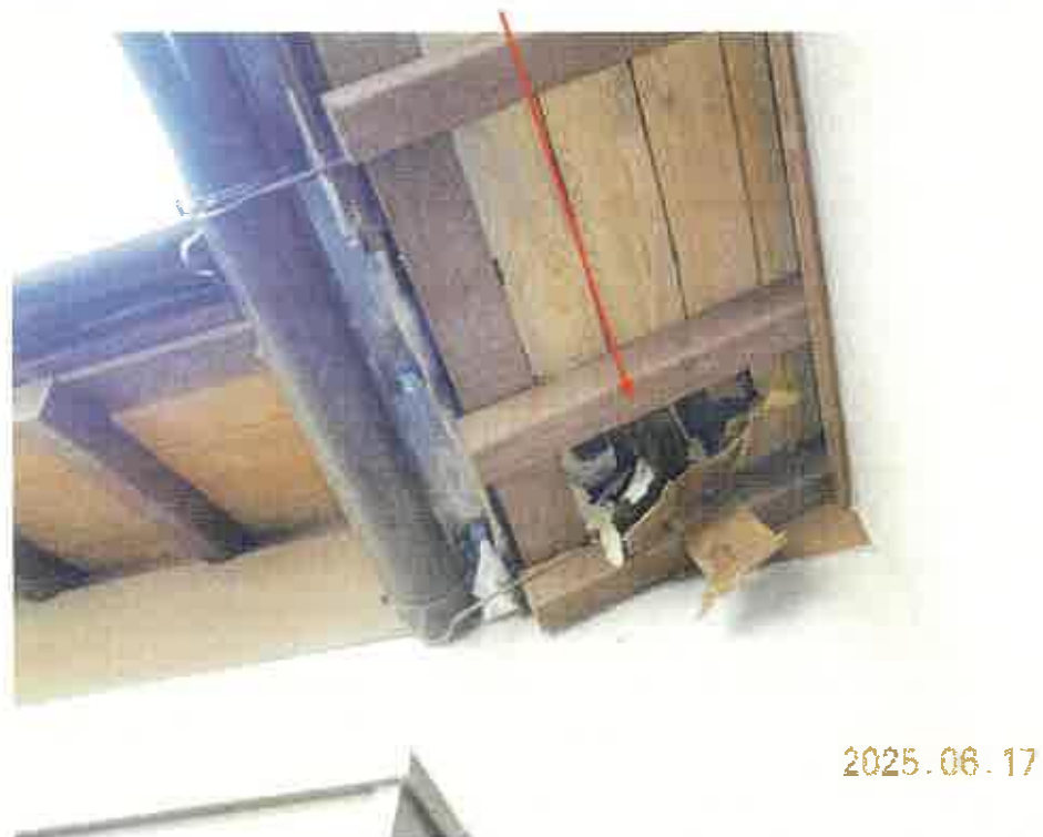
写真 1 8 物件 5 の建物の軒下部分の破損箇所（撮影位置の図示は省略）
