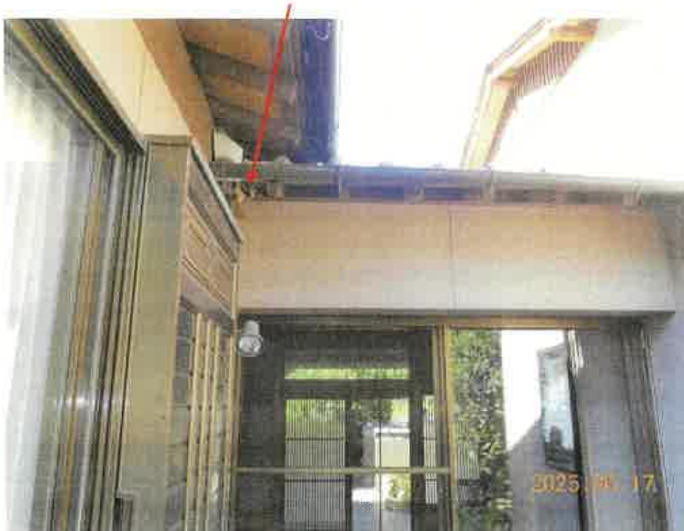
写真 1 7 物件 5 の建物の軒下部分の破損箇所
