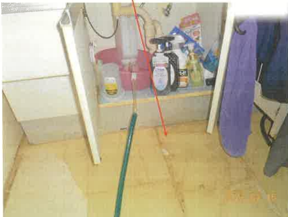
写真 1 2 本件建物 1 階洗面部分の水漏れによる床の損傷箇所（撮影位置の図示は省略）
