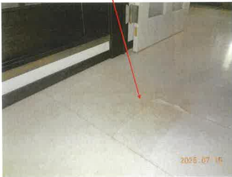
写真 1 5 本件建物 1 階リビングの床のはがれによる損傷箇所（撮影位置の図示は省略）
