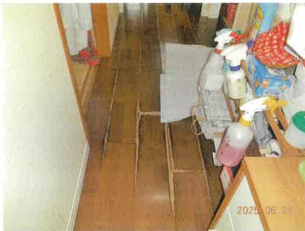
写真１９ 廊下のフローリング損傷箇所（撮影位置の図示は省略）
