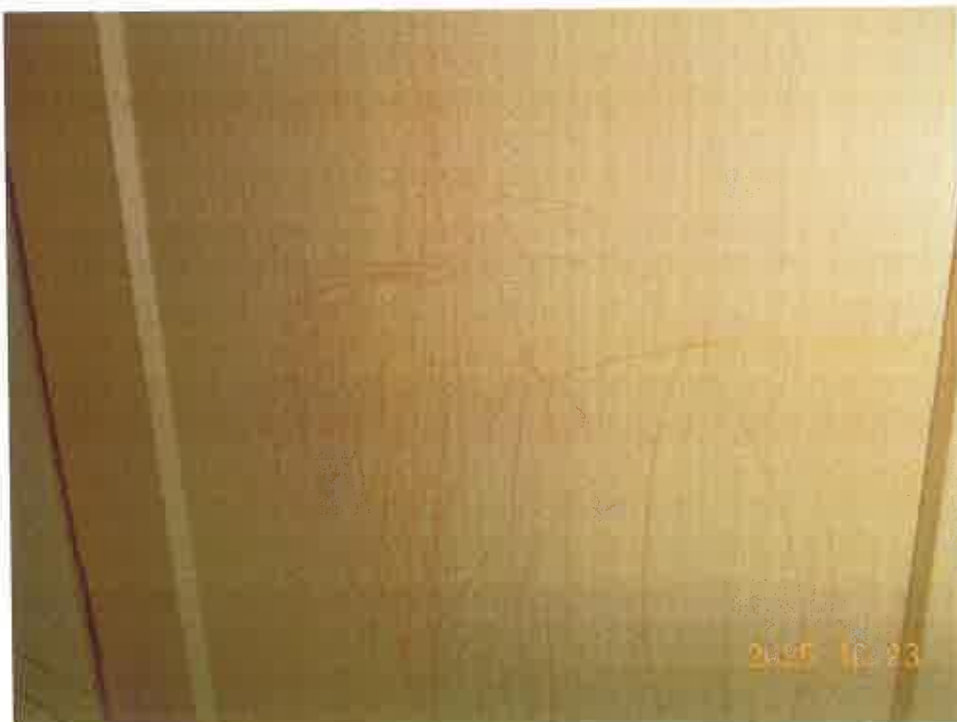
写真8 本件建物1階洗面室扉の落書き跡（撮影位置の図示は省略）
