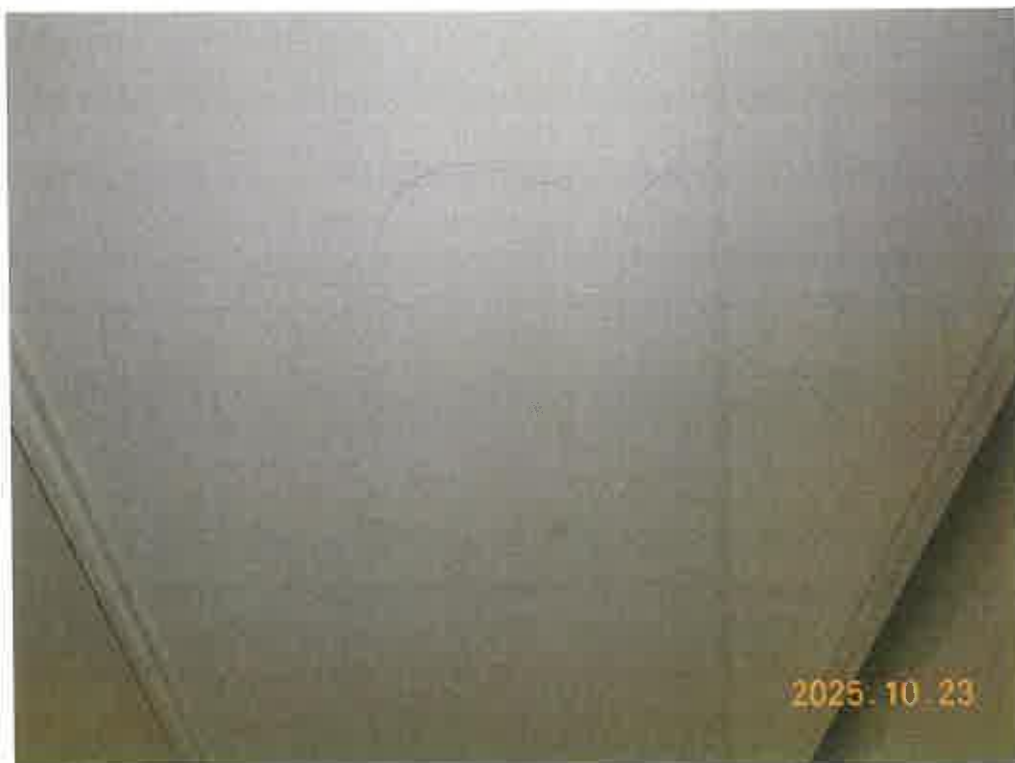
写真 2 4 本件建物 2 階東側洋室の内壁部分の落書き跡（撮影位置の図示は省略）
