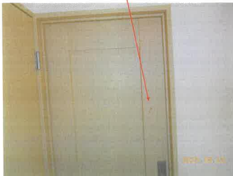
写真 2 2 本件建物 2 階東側洋室扉の損傷（凹み）部分（撮影位置の図示は省略）
