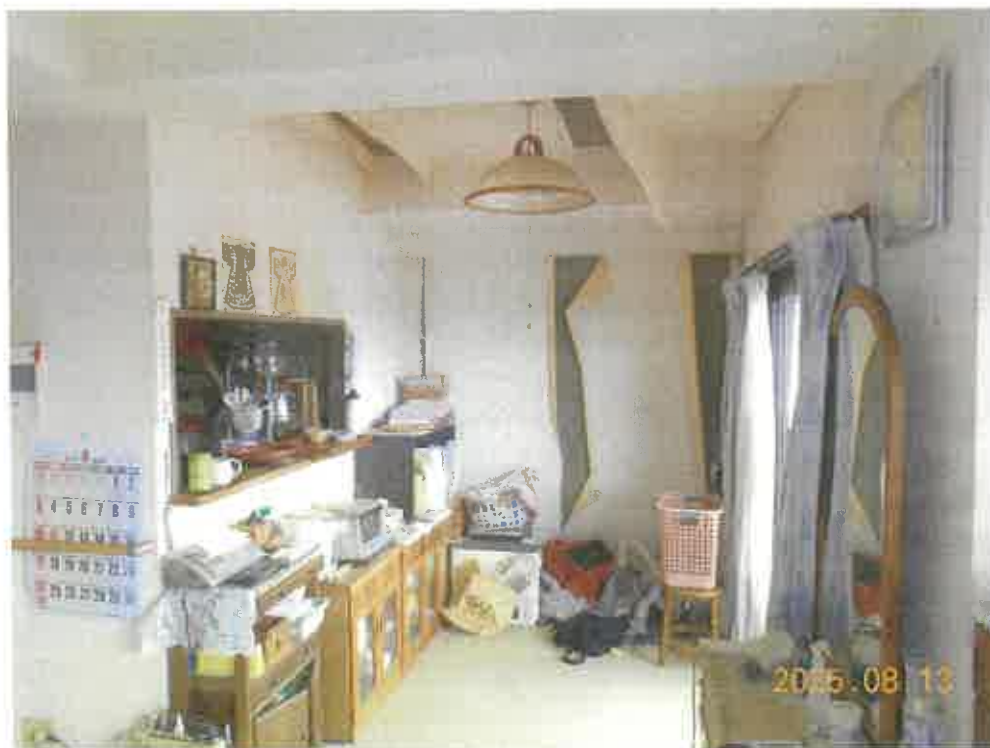
写真18 天井と壁クロスの剥がれ箇所
