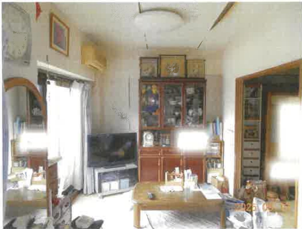
写真19 天井と内壁クロスの剥がれ箇所
