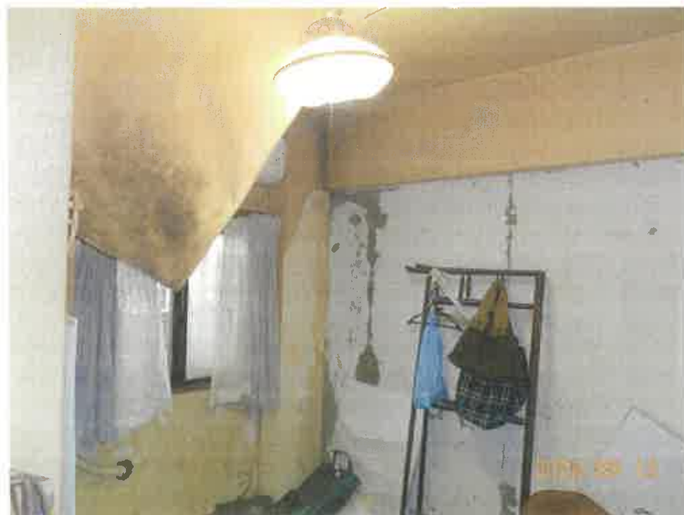
写真 1 2 天井と壁クロスの剥がれ及び壁の黒カビ箇所
