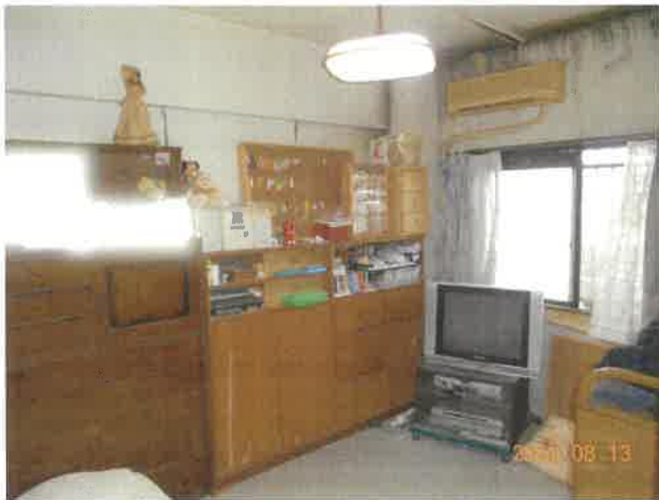
写真 1 1 天井と壁クロスの剥がれ及び壁の黒カビ箇所
