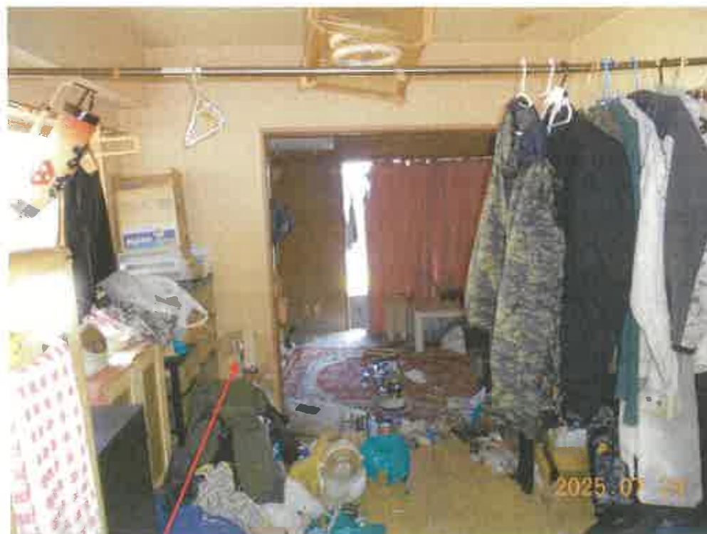
居間の内壁部分の損傷（穴）箇所
