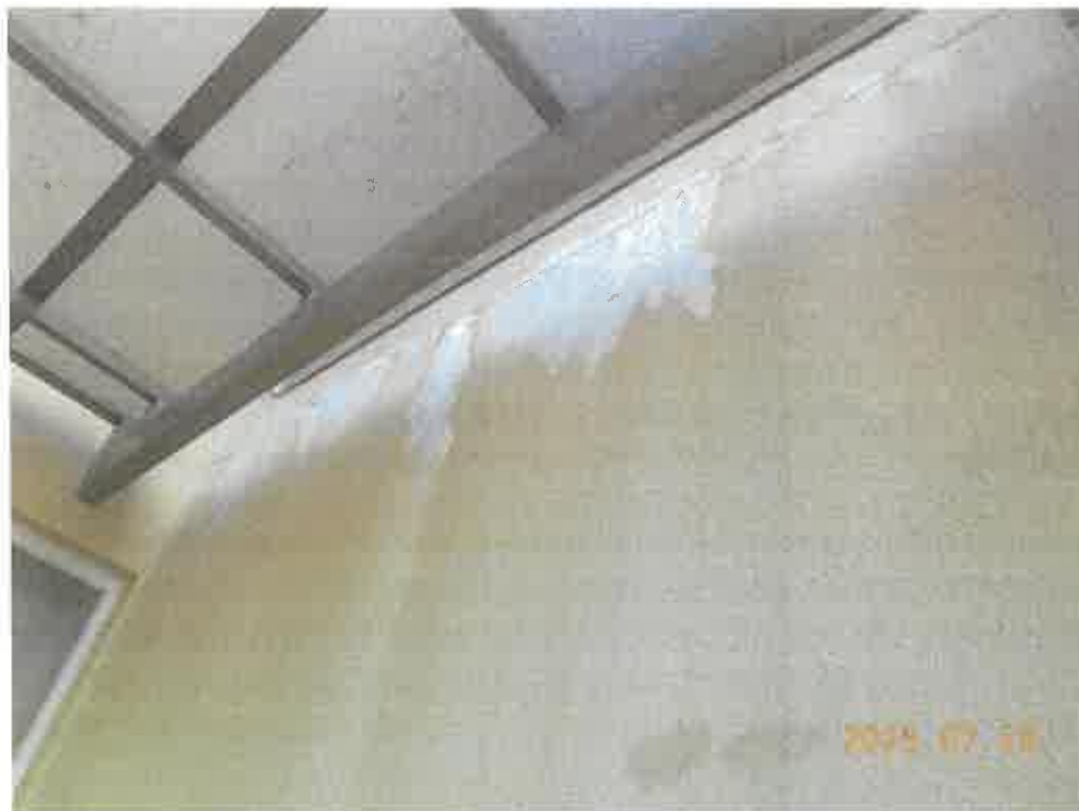
写真4 4 物件3の外壁塗装の劣化等による損傷箇所（撮影位置の図示は省）
