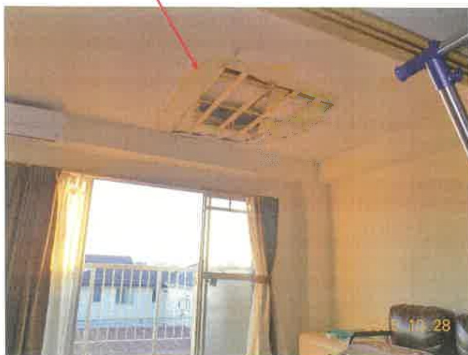
写真2 天井部分の不具合箇所（雨漏り・撮影位置の図示は省略）
