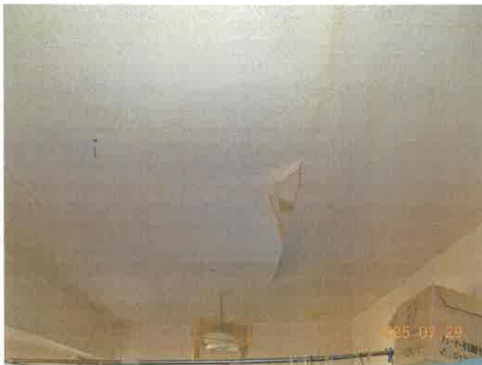
写真3 1 居間の天井クロス剥がれ箇所（撮影位置の図示は省略）
