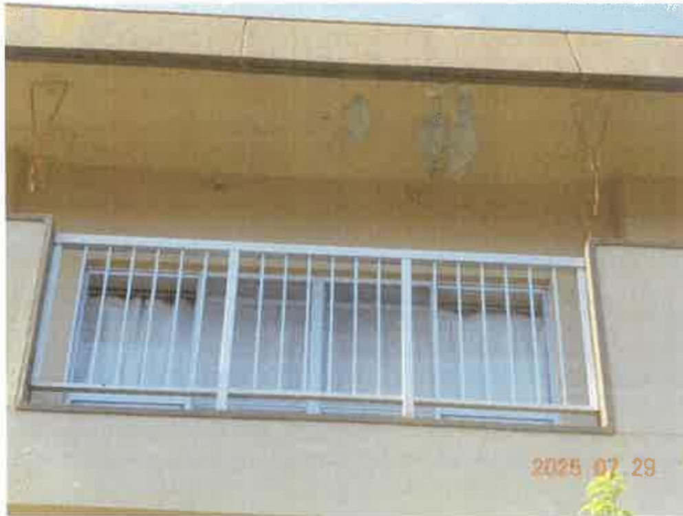
写真4 3 物件3の外壁塗装の劣化等による損傷箇所（撮影位置の図示は省）
