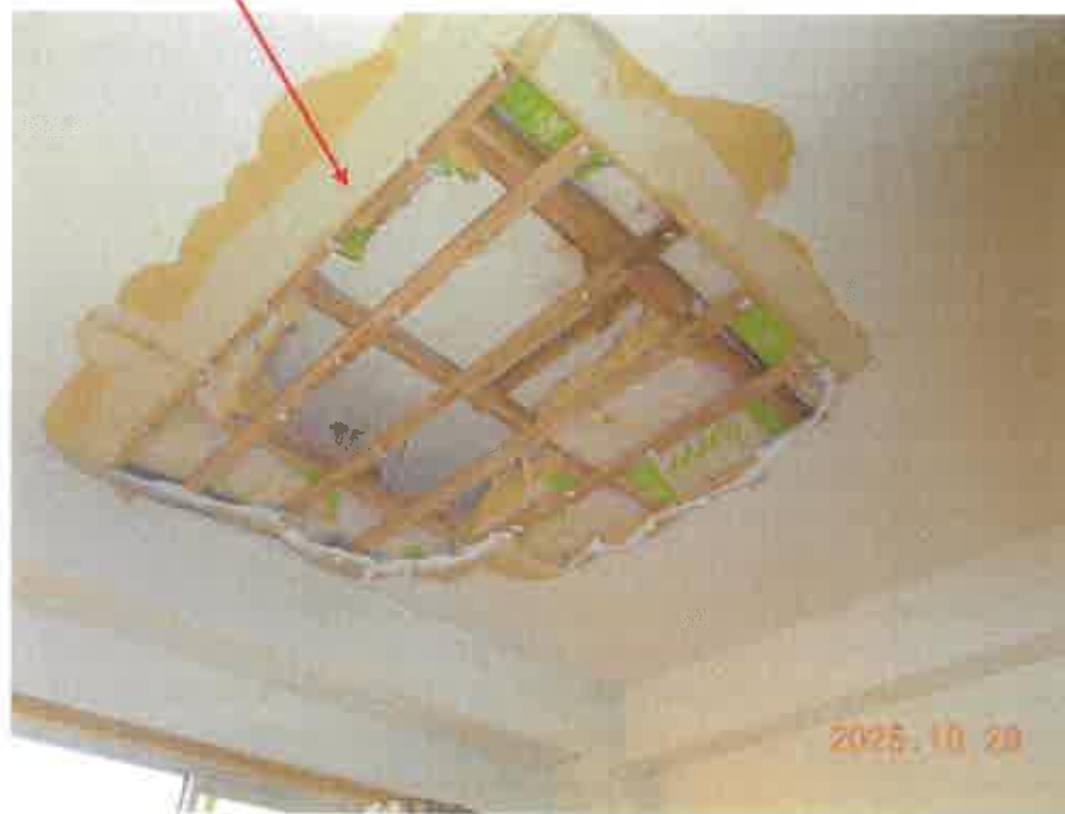
写真3 天井部分の不具合箇所（雨漏り・撮影位置の図示は省略）
