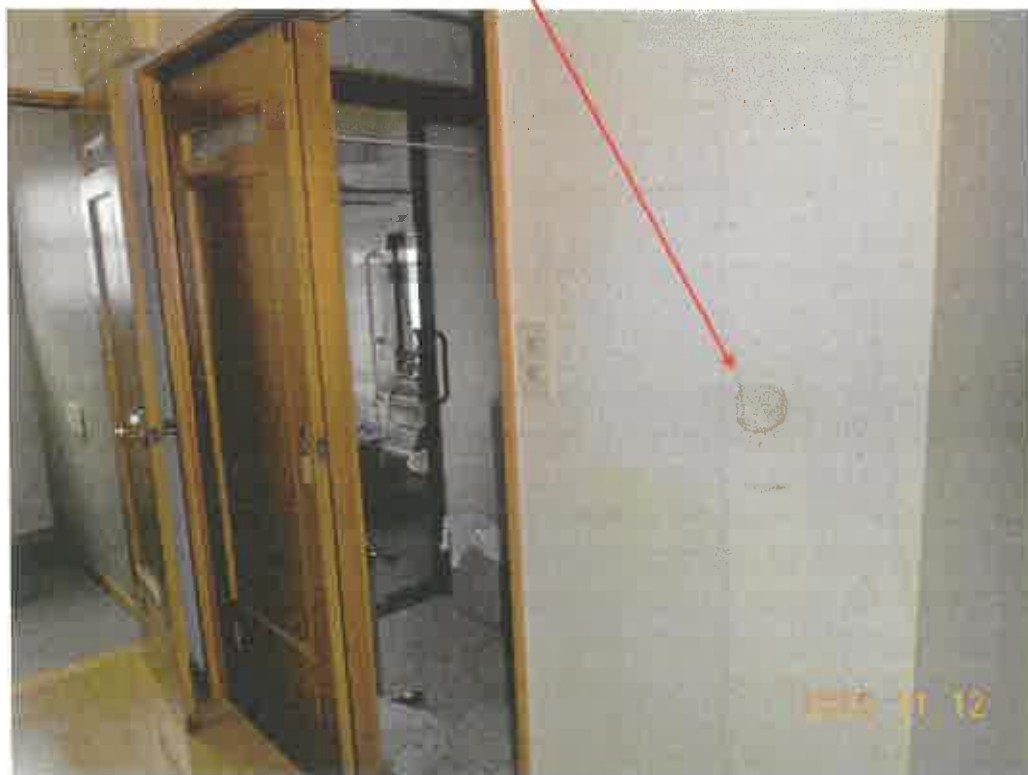
写真26 本件建物2階洗面付近の内壁の凹み箇所（撮影位置の図示は省略）
