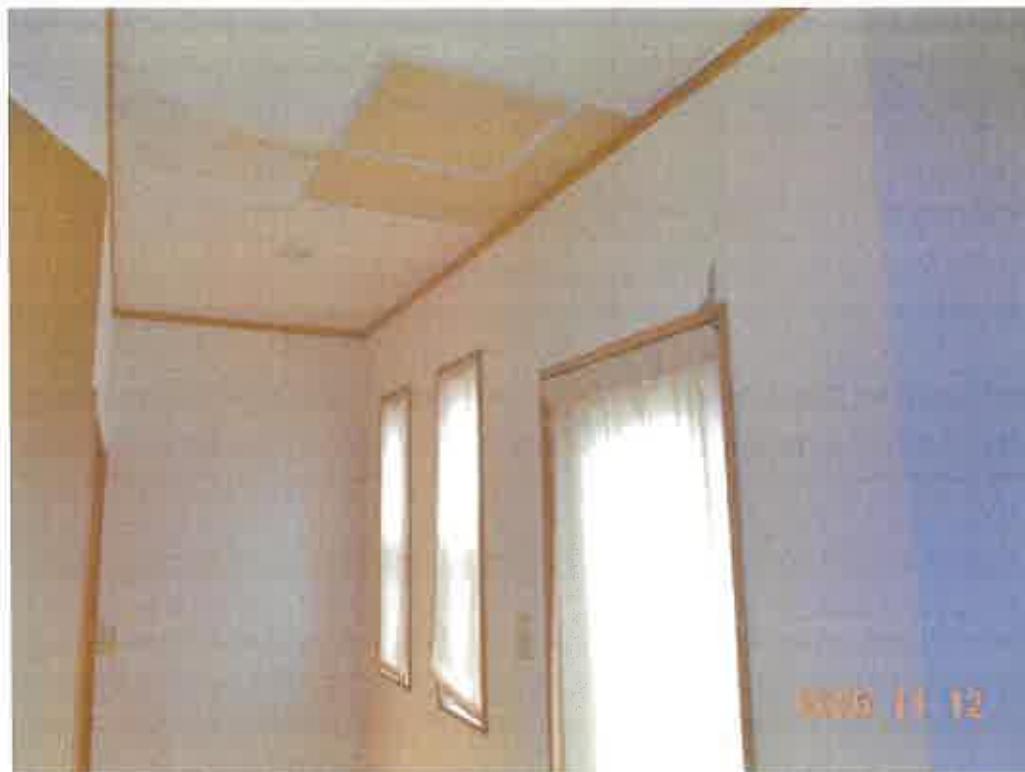
写真29 本件建物2階廊下の天井部分の雨漏り跡、補修跡、壁クロスの剥がれ跡
